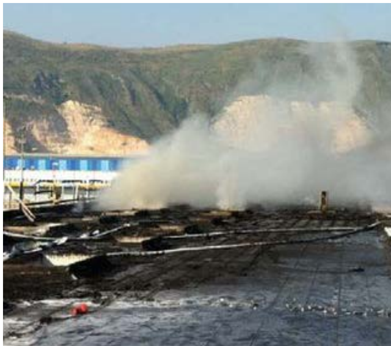
Εικόνα 8.6. Πυρκαγιά σε φωτοβολταϊκό πάρκο
