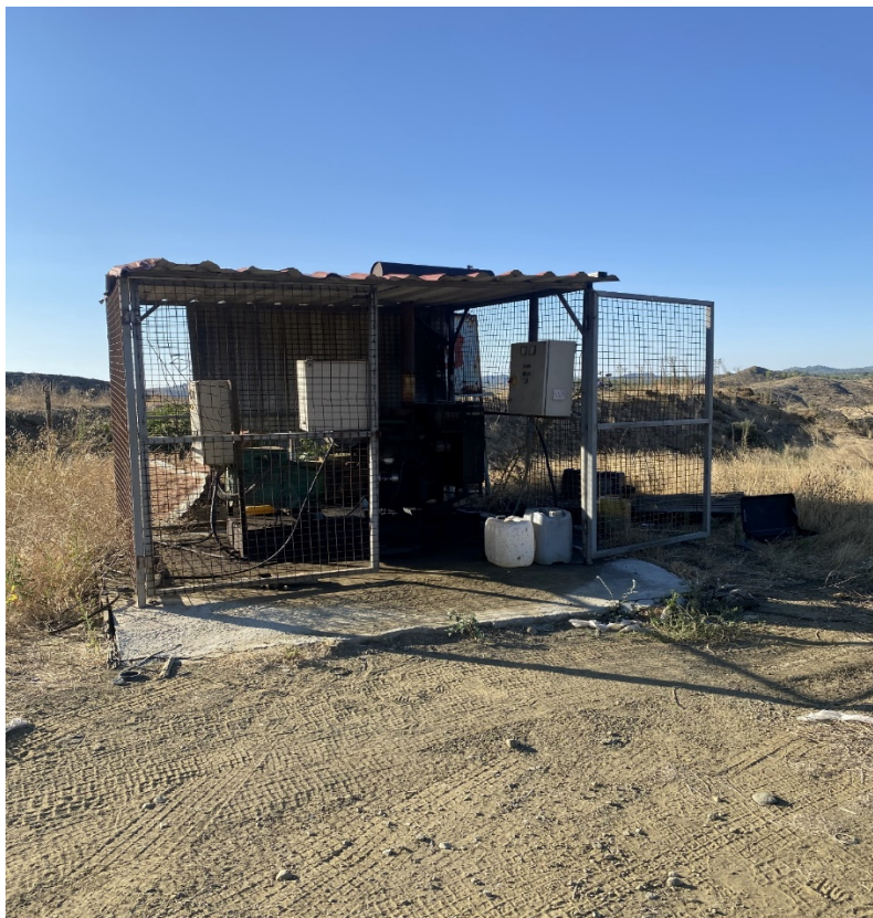
Εικόνα 6.9. Φωτογραφία (4) Γεννήτρια που βρίσκεται στα ανατολικά του τεμαχίου (Aeoliki Ltd, 2023)
